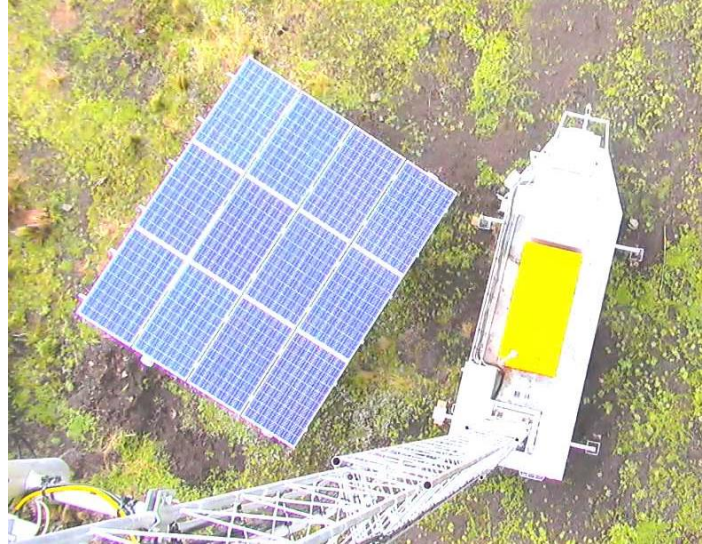
Figura 4. Imagen de vista de águila desde la cámara de videovigilancia instalada.
