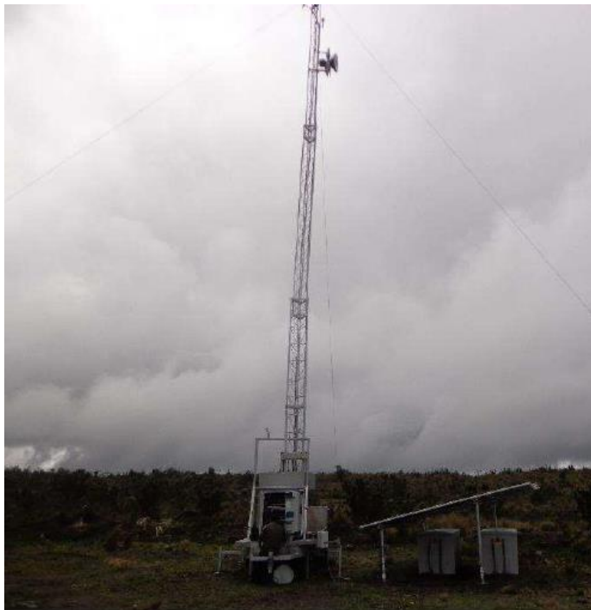
Figura 1. Imagen general de todo el sistema instalado.
